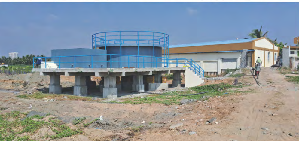
सीआईबीए के एमईएस में मछली हैचरी में 25 टन आरसीसी टैंक का निर्माण
